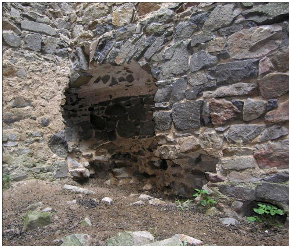
Obr. 79: Helfenburk, skříž (?) v severozápadním koutě sklepa západní obytné části paláce, úhlopříčný pohled z prostoru sklepa (srov. obr. 77 dole). Parapetní část zdiva je odlámaná, vnitřní výdřeva zanikla. Zcela vpravo dole kapsa po stropním trámu dolního sklepa, stav 2008.
