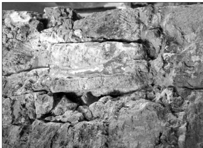
Obr. 16: Mušov, kostel sv. Leonarda, detail klenební konzoly severního pole letneru s patrným výběhem klínového prožlabeného žebra s bílým a výnově červeným nátěrem (foto D. Černoušková, 1996).
