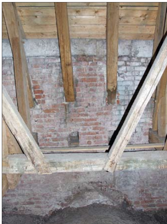
Obr. 7: Pouzdřany, kostel sv. Mikuláše, krov presbytáře – kapsy po vyřezaných vazných trámech, otisk čela klenební kápě.
