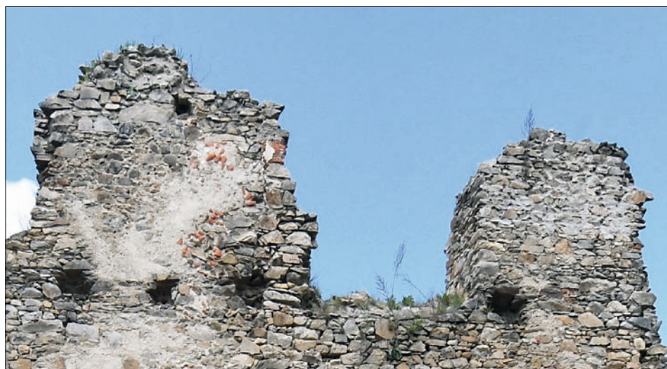
Obr. 11a, b: Helfenburk, porovnání detailů horní části západního nádvorního průčelí, stav 2008 a 2017 (srov. obr. 65). Při důležitém stavebním zabezpečení v mezidobí zanikl důležitý fragment římsy z několika lomových kamenů, úbytkem zdiva a nevhodnou povrchovou úpravou byl postižen i blok zdiva vpravo od proluky.
